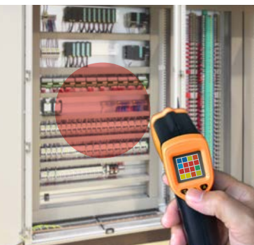
変圧器・配電盤
